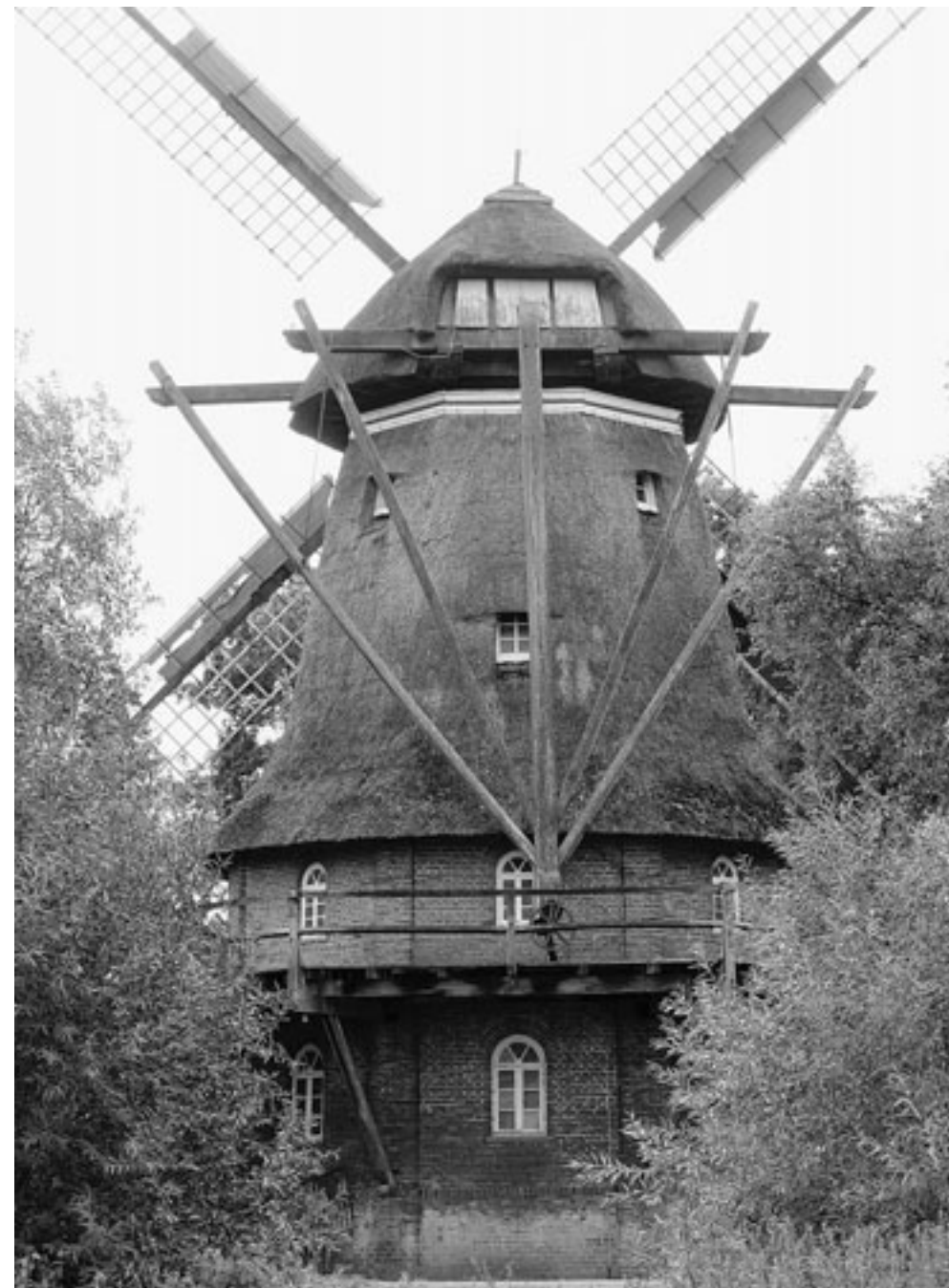
An der Ostersoder Mühle müssen die Bretter der Galerie erneuert und das Reetdach teilweise neu gedeckt werden. FOTO: HENNING HASSELBERG
